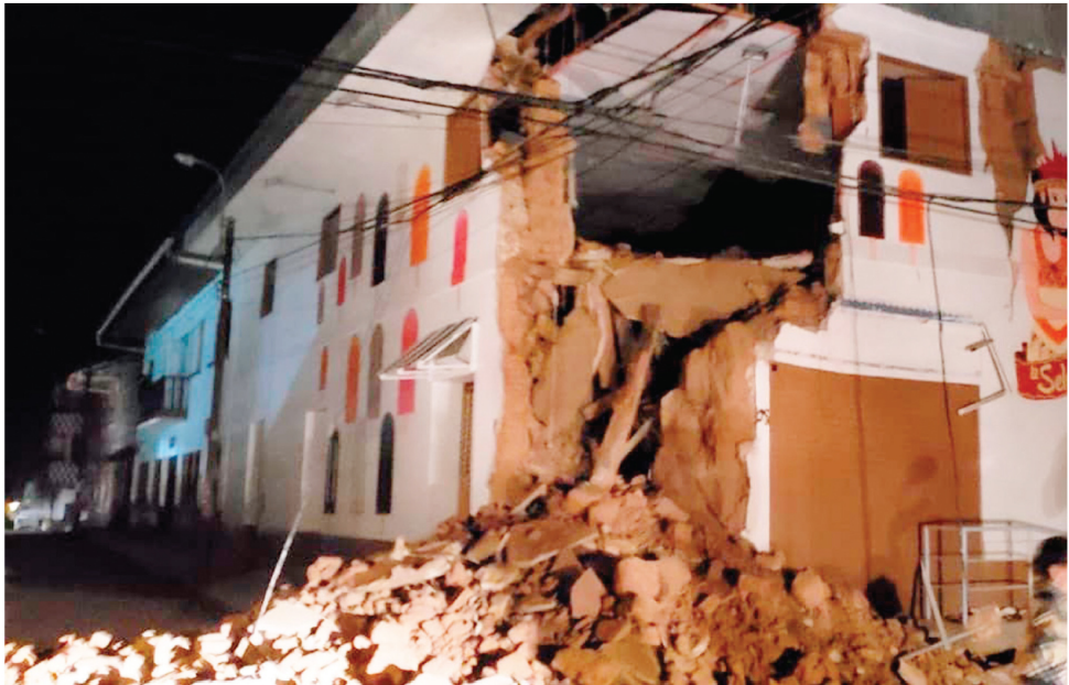
Varias edificaciones como este local resultaron dañadas por el terremoto de magnitud 8,0 en la ciudad de Yurimaguas, Perú, el domingo 26 de mayo.
